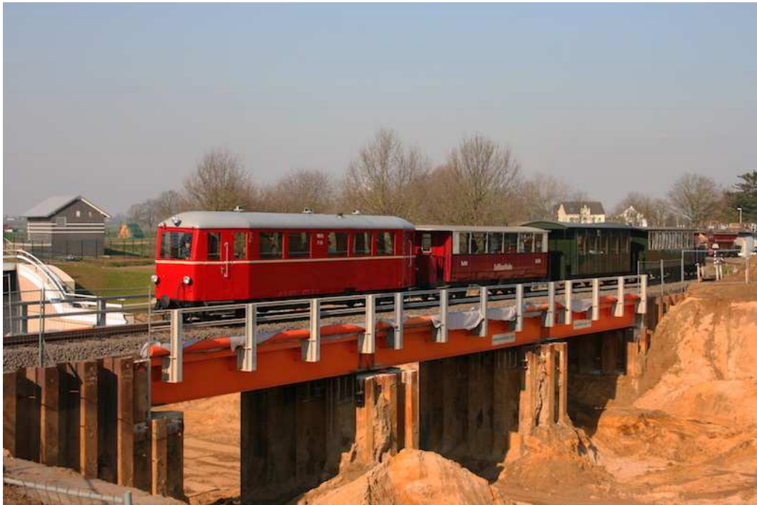
Behelfsbrücke mit umgebender Baugrube für ein neues Tunnelbauwerk mit der Selfkantbahn (Schmalspurbahn)
