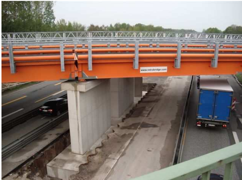
Behelfsbrücken Typ RHB + C200 über der BAB A1 Schiefwinklige Mittelstütze mit Koppelstelle der RHB-Brücken
